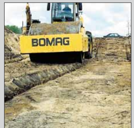
Взгляд на участок проведения испытания. Легко различима осадка.
